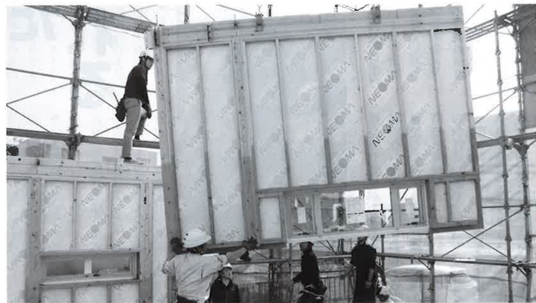
大型パネルには断熱材や冊子なども工場を組み込むことが可能。現場では重機で吊り上げ、ドリフトピンに差し込んでいくことで、1日で上棟、雨仕舞い、防犯対策まで完了する
