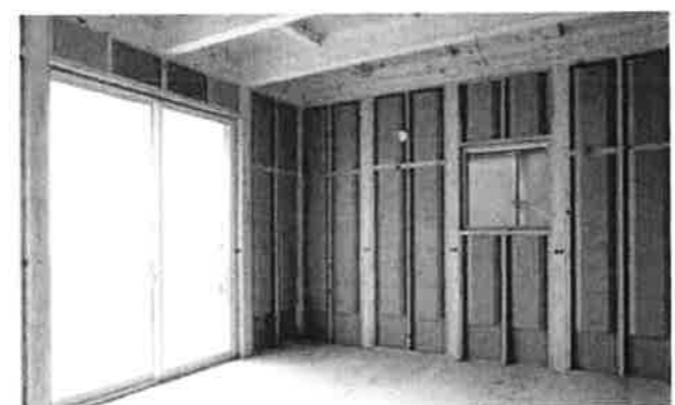
ソルツでは、工場でプレハブ化した耐力パネルを柱間にはめ込むだけでほぼ工事が完了。骨組みと耐力なパネルの組み合わせで、耐震等級3も確保した
